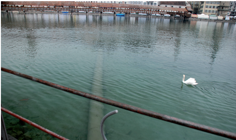
Meteorwasserleitung in der Reuss bei der Kapellbrücke in Luzern
